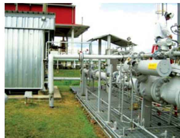
Figura 1. Sistema de Transferencia de Custodia
