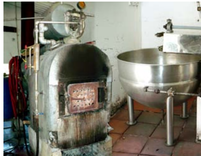
Figura 3. Marmitas de Vapor directo, con Calderas a Carbón.
