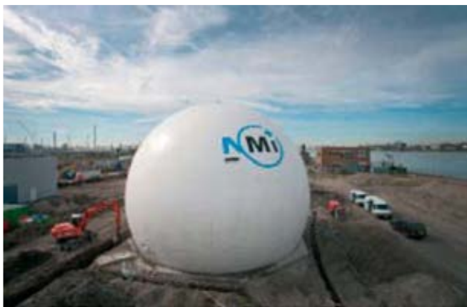
Figura 7. Contenedores de gas.
